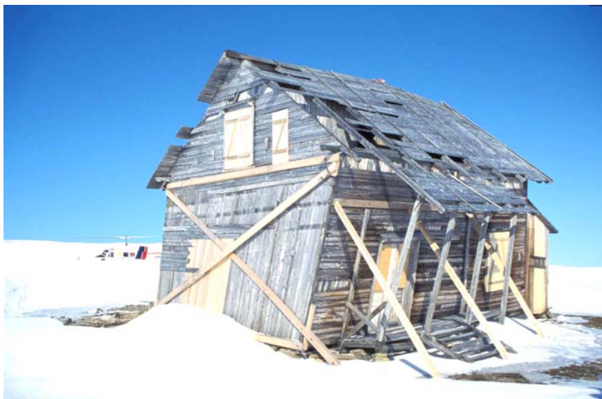
Figur 56. Gæverhuset i 2003. Sysselmannen på Svalbard har utført et forfallsforsinkende vedlikehold ved å avstive og jekke opp bygningen.
